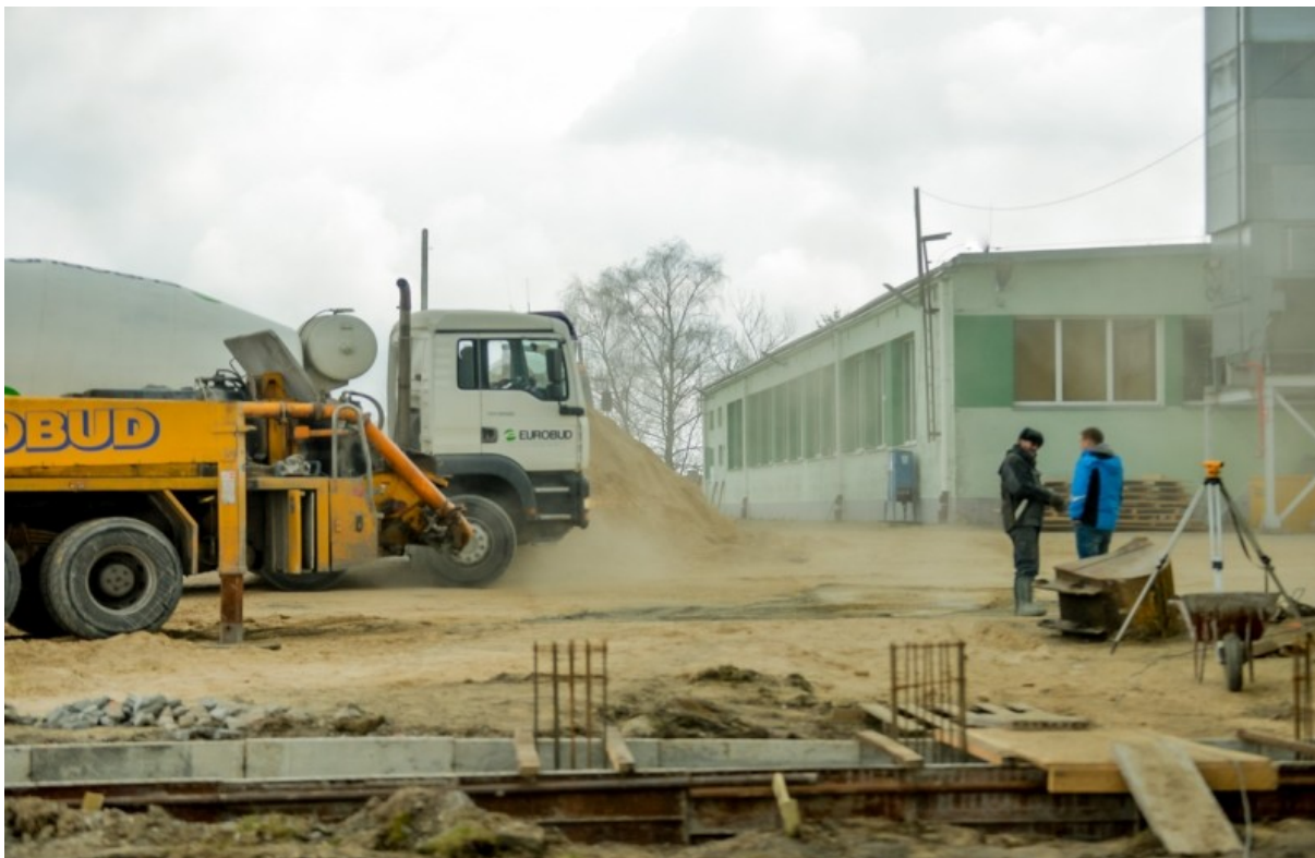
Nowa hala ukończona zostanie w październiku i będzie najwyżej położoną fabryką w regionie. fot. KAM
